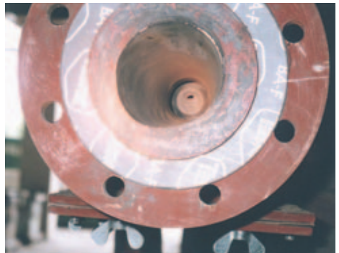
Abb. 2: Auswaschungen an einem Stahldiffusor nach der Förderung von stark schleißender Grobasche
